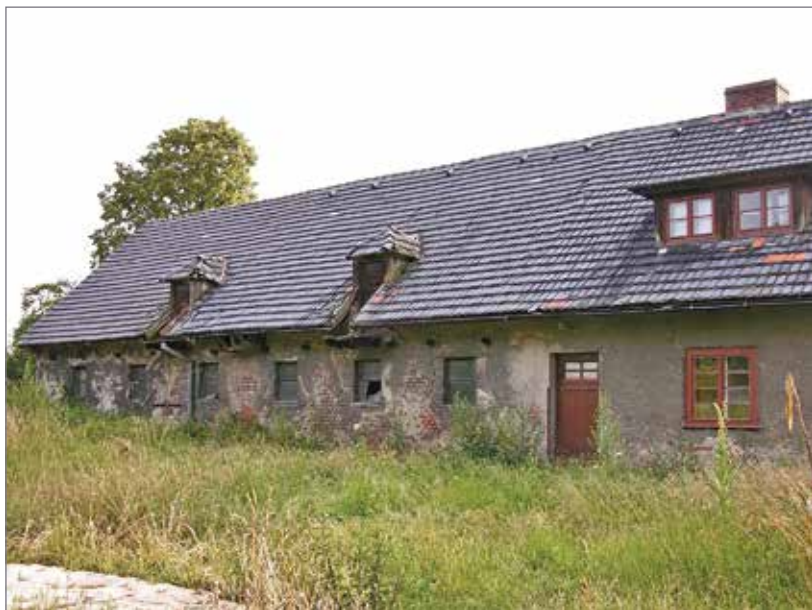
„Duży” budynek mieszkalno-gospodarczy w ruinie (lata 30. XX wieku)
