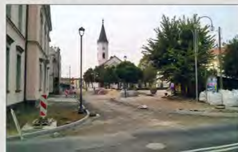
Przebudowa ulic i chodników wokół dobrodzieńskiego rynku / Umbau der Straßen und Bürgersteige rund um den Guttentager Ring Fot. / Abb. Paweł Mrozek, 24.09.2016
